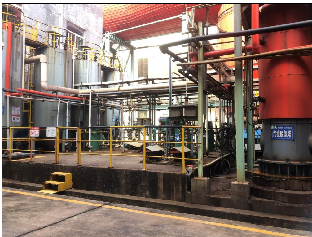
图 4.1-5 脱硫制酸废水处理站照片
