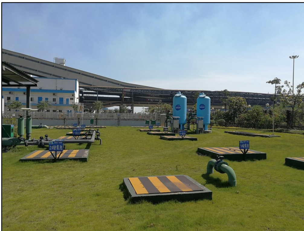
图 4.1-3 生活污水处理站（地埋式）照片
