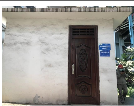
新 2#高炉出铁场除尘在线监测室
