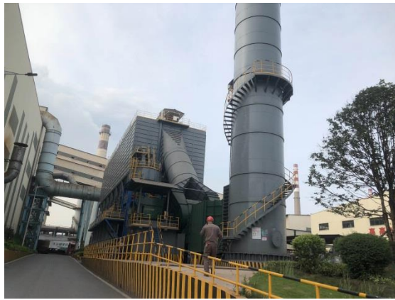
新 1#2#转炉铁水预处理除尘设施及排气筒
